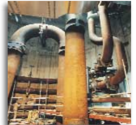
Fernwärmeschacht mit Verrohrung
