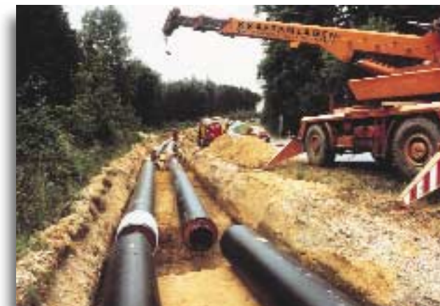
FW-Versorgungs- leitung HKW Zolling- Flughafen München II
