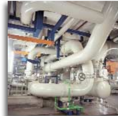
Kraftwerk Lippendorf Zwischenkühlwasserleitung
