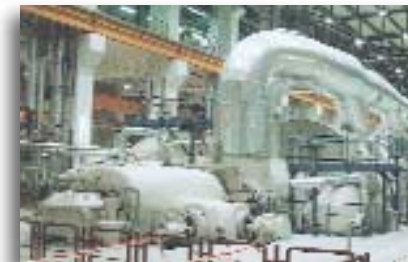
Kraftwerk Lippendorf Turbinenverrohrung
