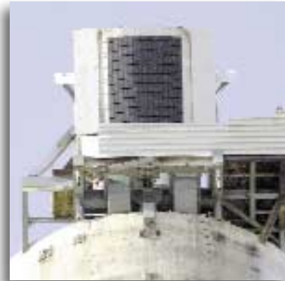
Solaranlage Receiver vor Betrieb
