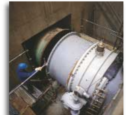
Kraftwerk Niederaußem Hauptkühlwasserleitung
