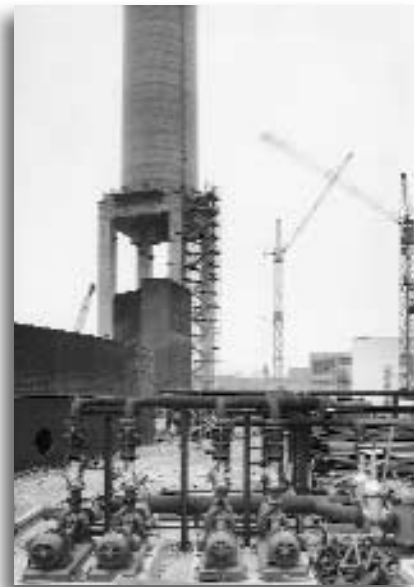
Pumpstation für Ölversorgung im Heizkraftwerk Freimann
