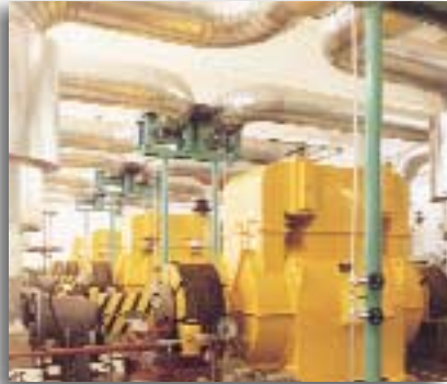
Pumpenhaus mit Netzumwälz- pumpen im Heizkraftwerk
