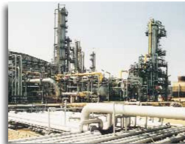
Produktleitungen Raffinerie Ingolstadt
