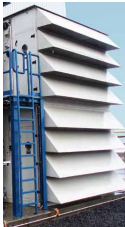
Zuluftgerät der Turbinenhalle im GuD-Kraftwerk Kårstø (Norwegen).
